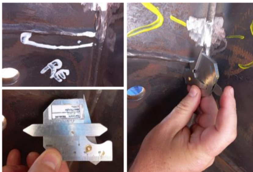
FIGURA 9. Excesso de metal de solda na face de solda. Fonte: Autor (2023).
