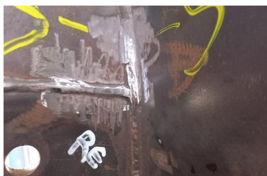
FIGURA 14. Remoção do reforço excessivo. Fonte: Autor (2023).
