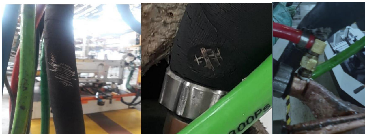
FIGURA 1. Mangueiras danificadas pelo atrito dos componentes.
