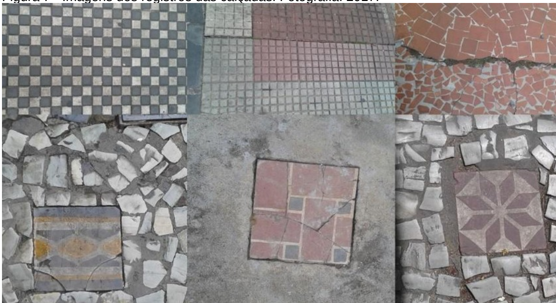
Figura 7 - Imagens dos registros das calçadas. Fotografia. 2017.
