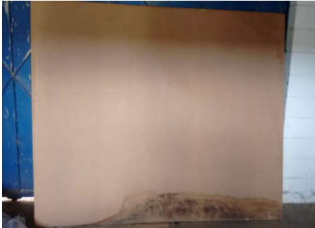
Madeirite danificado por causa das chuvas
