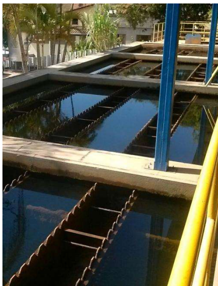
Figura 3: Decantadores laminares, Estação de Tratamento de Água de Itabirito - MG
