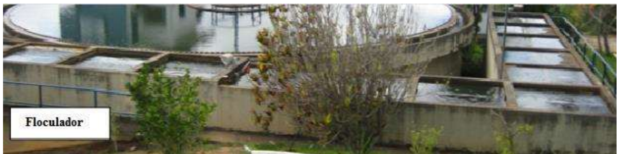
Figura 4.6. Tanque de Floculação da ETA I- SAAE de Viçosa/MG.
