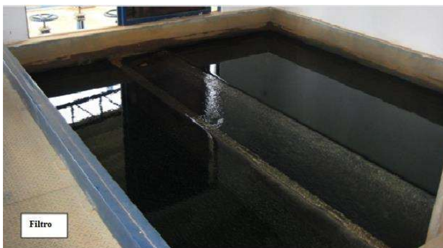
Figura 4.8. Sistema de filtração da ETA I – SAAE de Viçosa/MG.
