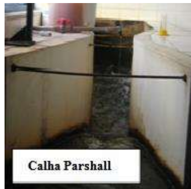
Figura 4.5. Calha Parshall da ETA I – SAAE de Viçosa/MG.
