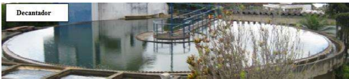
Figura 4.7. Tanque de Decantação da ETA I – SAAE de Viçosa/MG.
