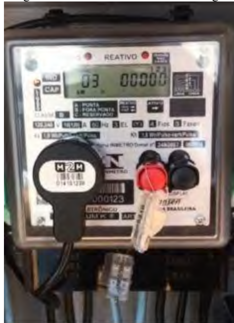
Figura 12 - Medidor Bilateral de Energia.
