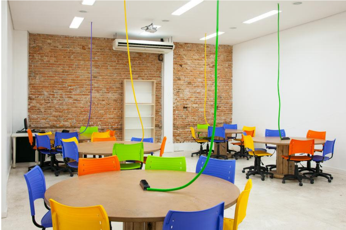
Imagem 01 – Espiral para Acomodação de Cabos
