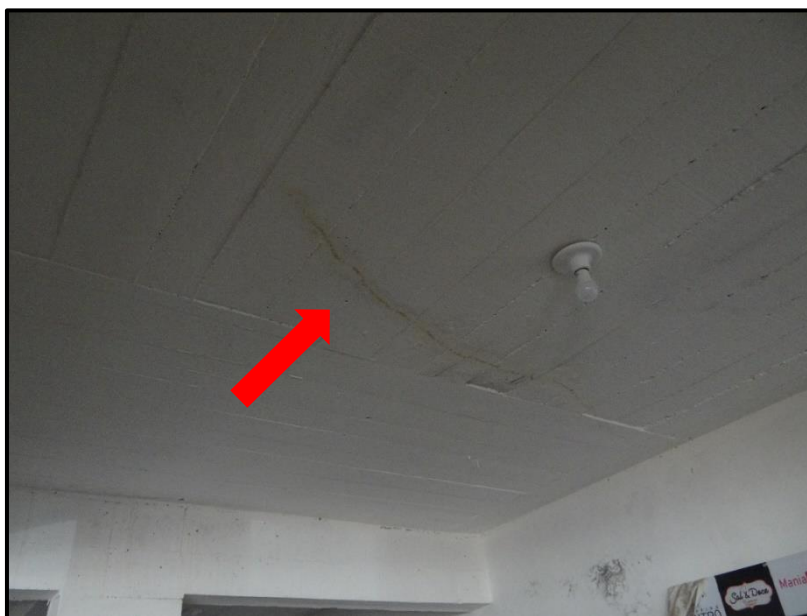
Figura 9 - Fissura em laje.
