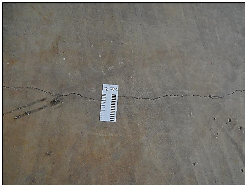
Figura 12 - Fissura em piso.
