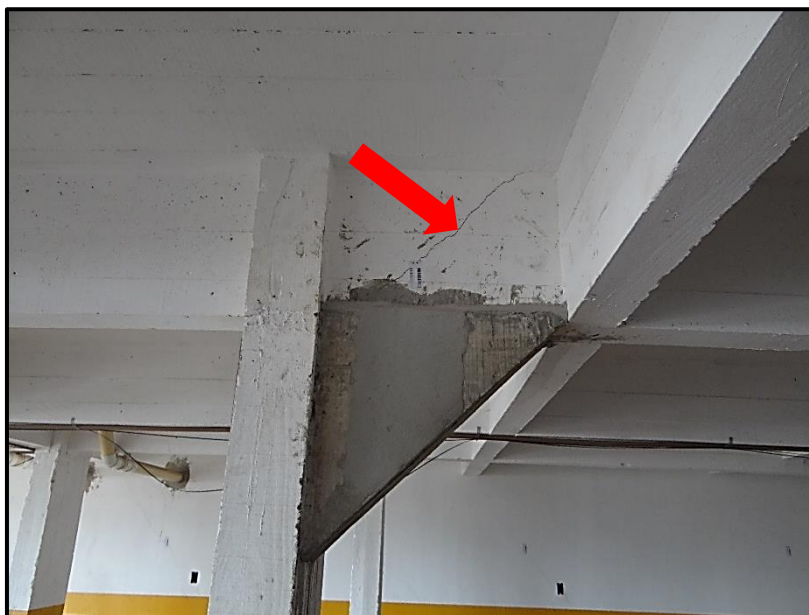
Figura 10 - Fissura em viga.
