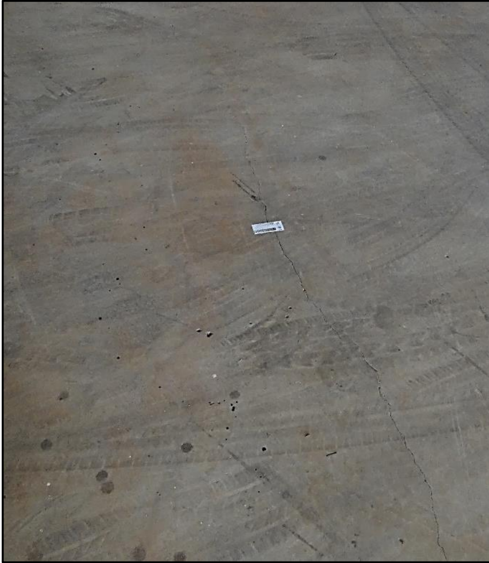
Fissura em piso devido a retração do concreto em subsolo -1.
