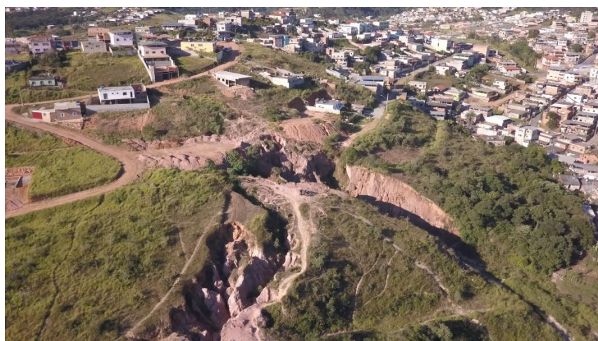
Figura 07: Visão panorâmica do processo erosivo no Bairro Vista Alegre em Barbacena – MG. Fonte: Levantamento em campo, 2018.
