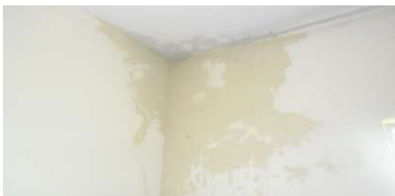
Figura 4: Exibe a área interna do serviço, com presença de infiltrações. Os atendimentos eram realizados nesse ambiente.
