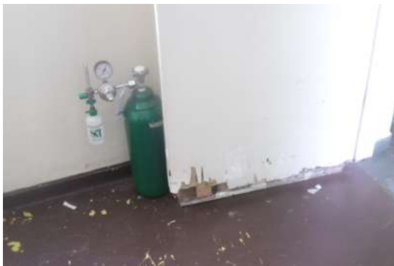
Figura 7: sala da enfermagem. Observa-se a ausência de pisos no chão e parede, conforme determina a Vigilância Sanitária para o funcionamento adequado.
